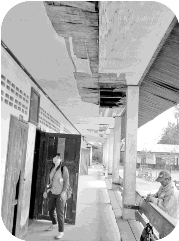
傷みが激しい天井
