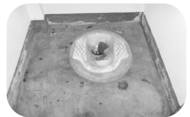
ナカン村小学校のトイレ - 修理が必要
