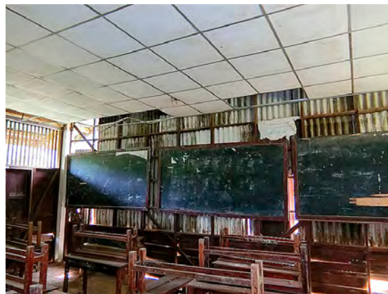
教室内の破損した天井
